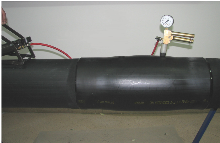
Fot. Nr 34 Zamocowanie manometru kontrolnego
