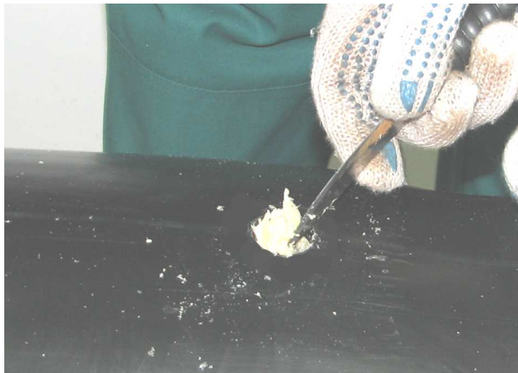
Fot. Nr 54 Usunięcie pianki PUR z otworów wlewowych na głębokość ok. 5mm.
