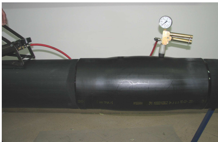
Fot. Nr 34 Zamocowanie manometru kontrolnego
